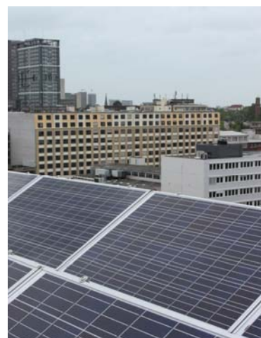
Photovoltaikanlage auf dem Dach der Wohnanlage Hammerbrook
